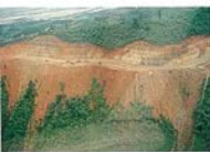
พื้นที่เกิดผลกระทบจากการพังทลาย และการเลื่อนไหลของดิน บริเวณ กม.๑๘ ถนนสายลี้ก่อง-พระราชดอยตุง
