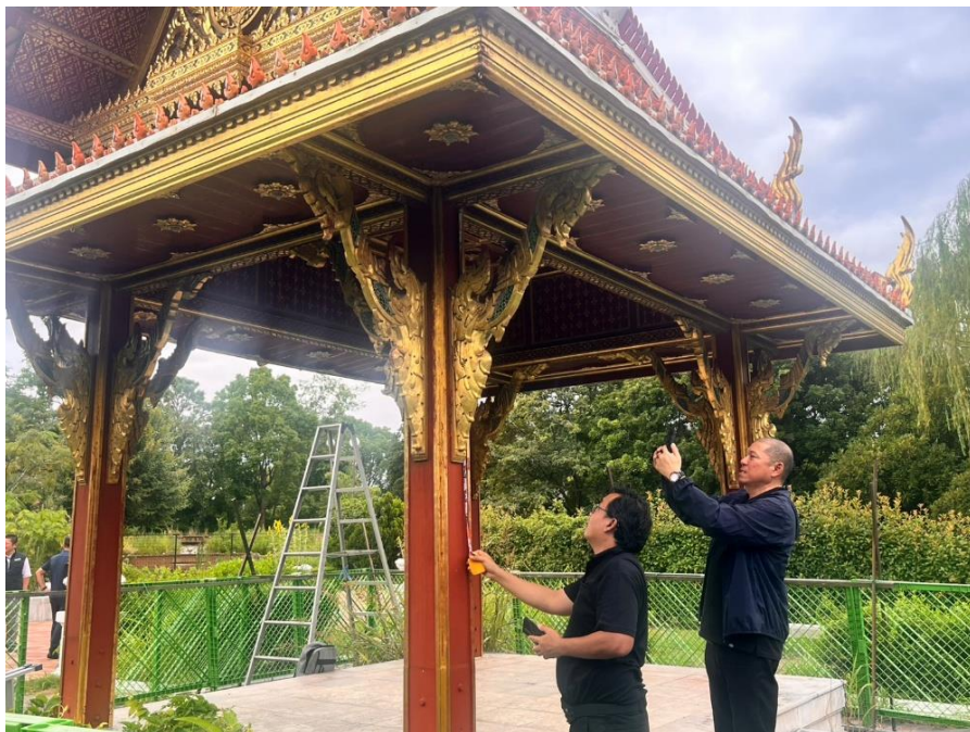
การสำรวจและวิเคราะห์ความเสียหาย และขนาดของเสา และคันทวยเพื่อจัดทำแบบซ่อมแซม
