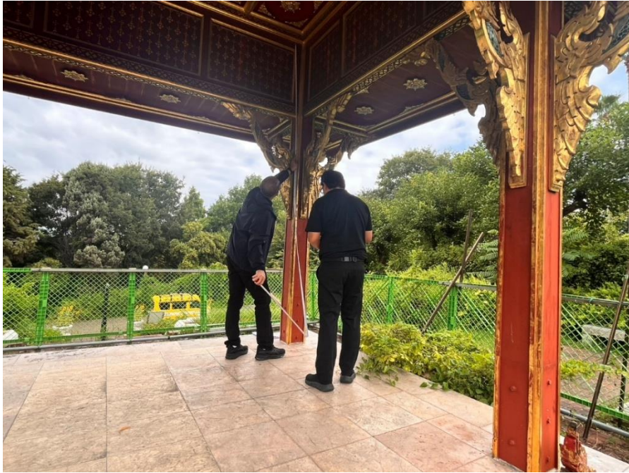
การสำรวจและวิเคราะห์ความเสียหาย และขนาดความสูงด้านในของเสา และคันทวยเพื่อจัดทำแบบซ่อมแซม
