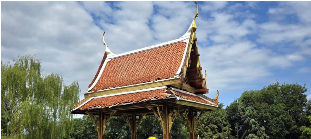
ในส่วนของอาคาร บริเวณที่ชำรุดมากที่สุดเป็นส่วนของหลังคาปีกนก ด้านหลังโครงสร้างสะพานหนูหลุดออก ทำให้หลังคาหลุดร่วง และ พบว่ามีการทรุดตัวของโครงสร้างหลังคา และ ฝ้าเพดาน คันทวยหักเสียหาย และ ส่วนประดับตกแต่งหลังคา มีการชำรุดหัก หลุดหายไปบางส่วน
