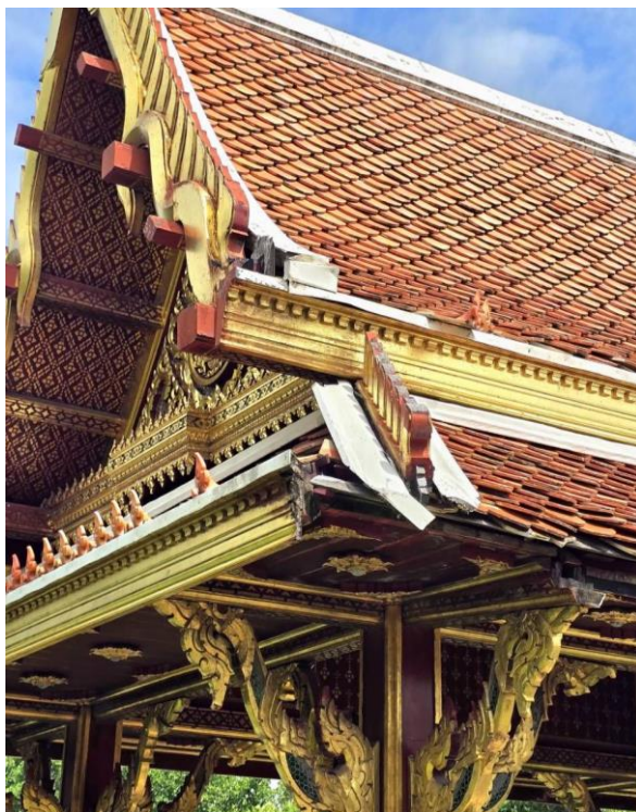
สภาพความเสียหายของหลังคาปีกนก
