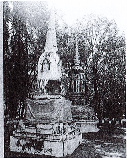
สภาพความชำรุดของเจดีย์ ก่อนดำเนินการบูรณะ
