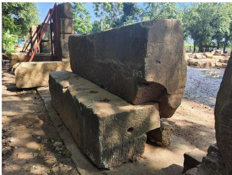
ภาพที่ ๘ แสดงรายละเอียดการยึดทับหลังติดกับโครงสร้าง
