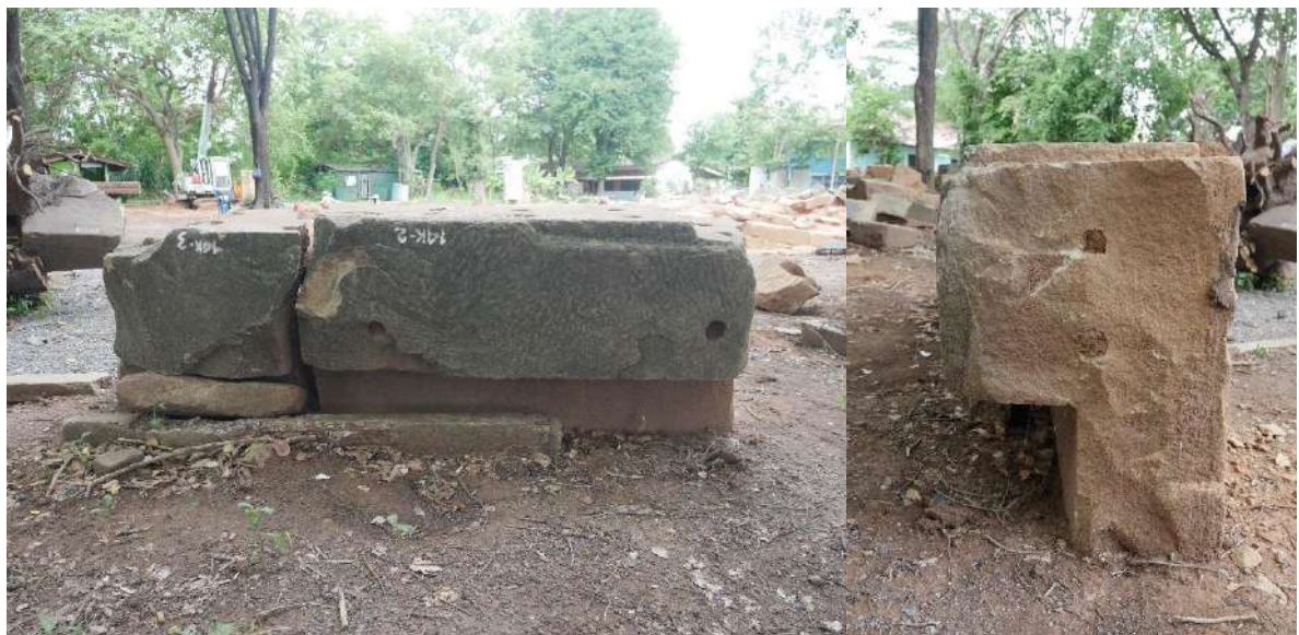
ภาพที่ ๕ - ๖ แสดงรายละเอียดการยึดทับหลังติดกับโครงสร้าง
