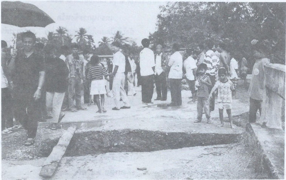
ความเสียหายของถนน-สะพาน อันเนื่องมาจากน้ำท่วมครั้งที่แล้ว
